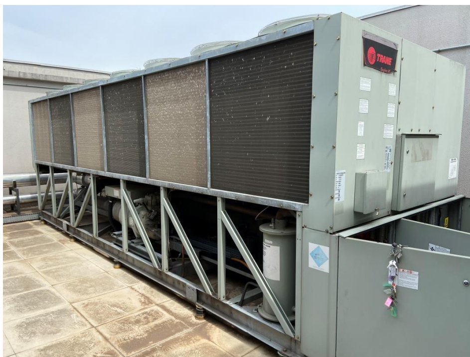
Anexo II - "Chiller" Industrial UR01
