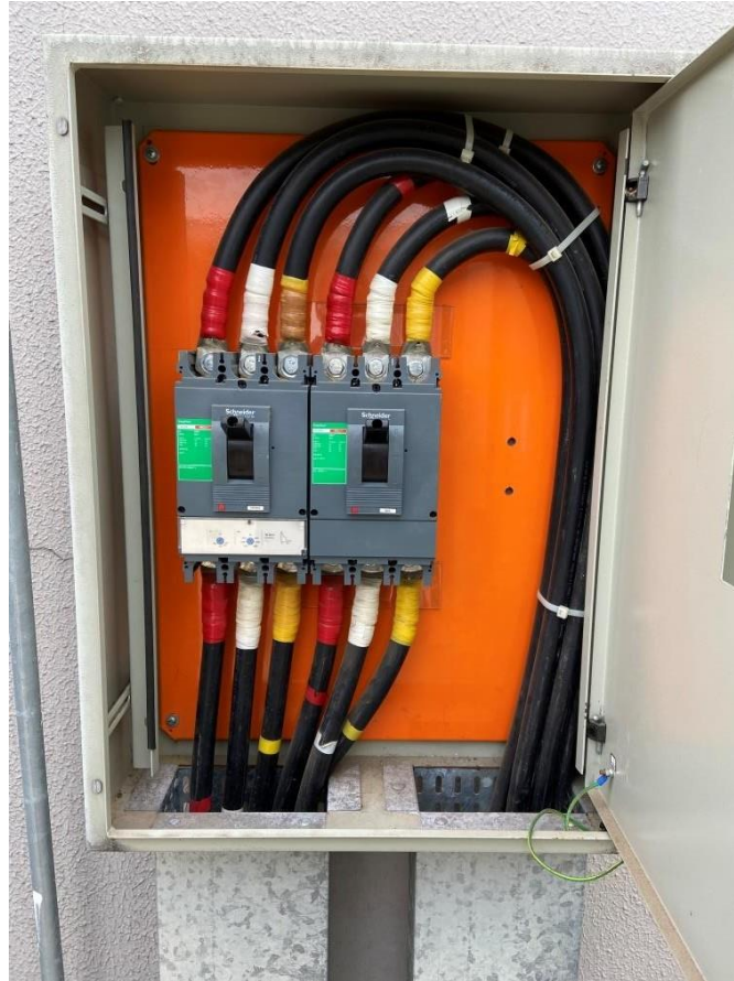
Anexo III - QGBT do "Chiller"
